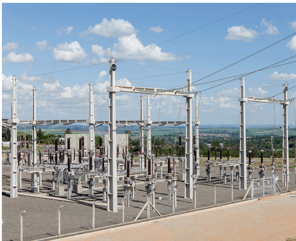
Subestação capacitada para 90 MW, o suficiente para abastecer uma cidade com 140 mil habitantes
